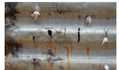
Schäden an den Wassertanks
