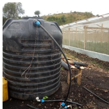
Hochgepumptes Wasser vom Brunnen, zur Nutzung in Gewächshaus
