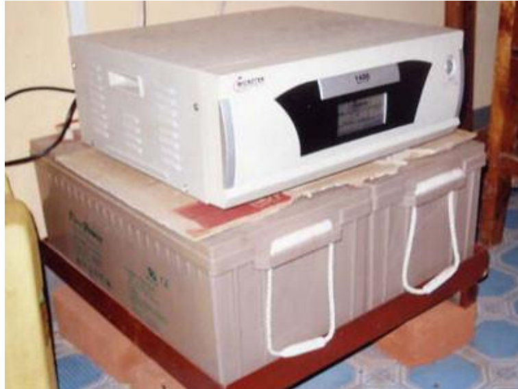
Die Batterie zum Energie holen für den Strom der Solaranlage
