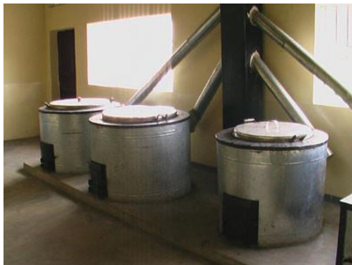
Drei neue Öfen in der Küche
