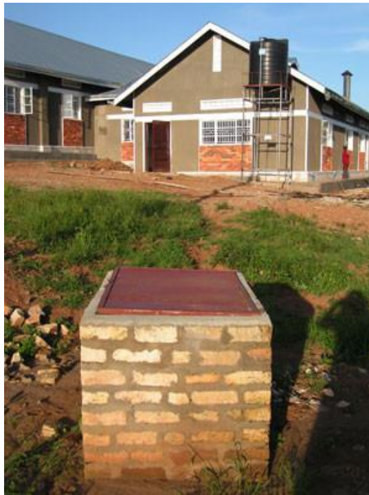
Der Hauptwasseranschluß vor dem Schulgelände
